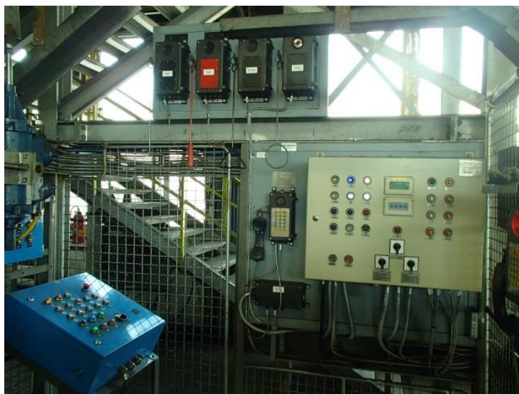
Rys. 5. Stanowisko sygnałowe wraz z pulpitem sterowania urządzeniami przyszybowymi [10]
