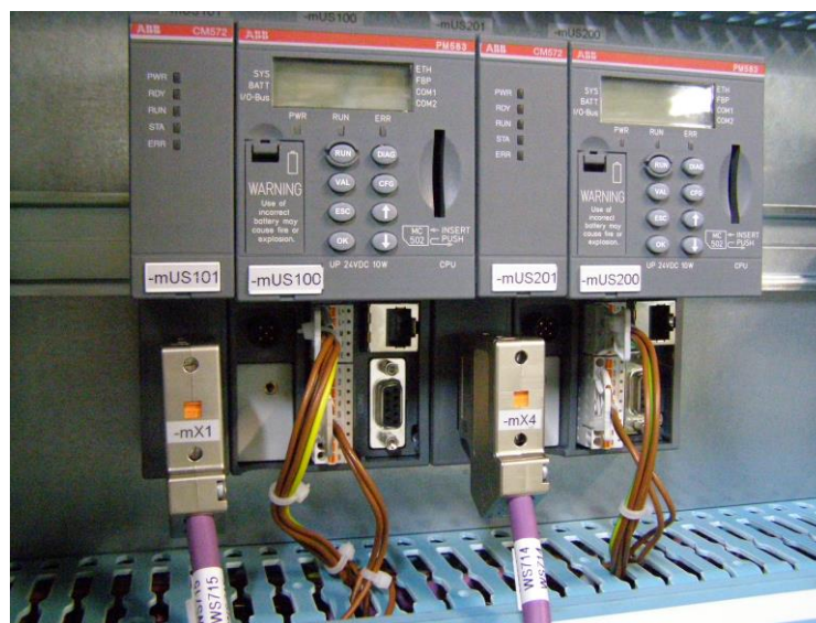
Rys. 3. Sterowniki PLC urządzenia sygnalizacji szybowej [10]
