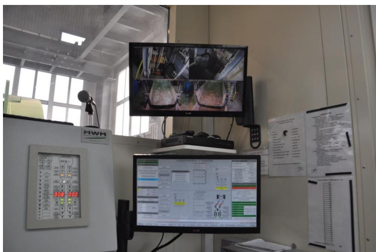
Rys. 2. Monitory systemu wizualizacji na stanowisku sterowniczym maszyny wyciągowej [8]
