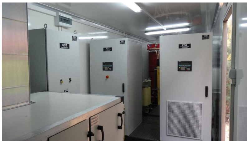
Rys. 5. Wnętrze tyrystorowej przetwornicy przewoźnej EL-TPP1 [8]
